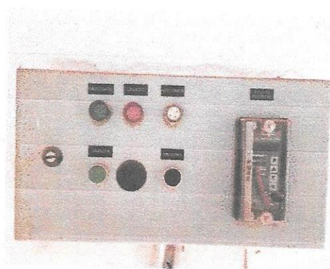
Relé Pextron URPE 7104 - instalado
