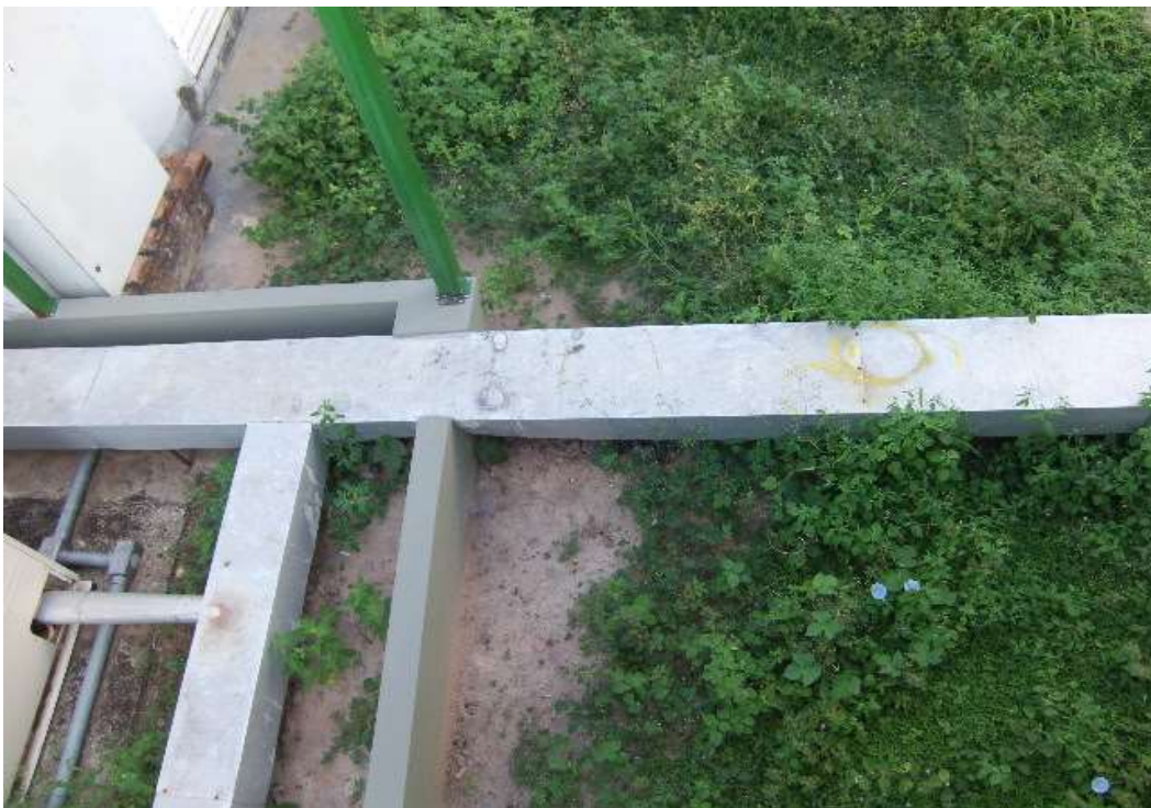
Figura 11 Saída tubulação frigorífera
