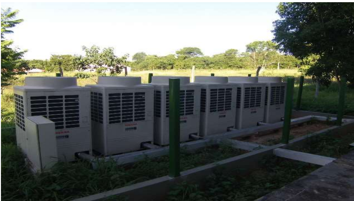
Figura 6 - Condensadoras Bloco de Laboratórios
