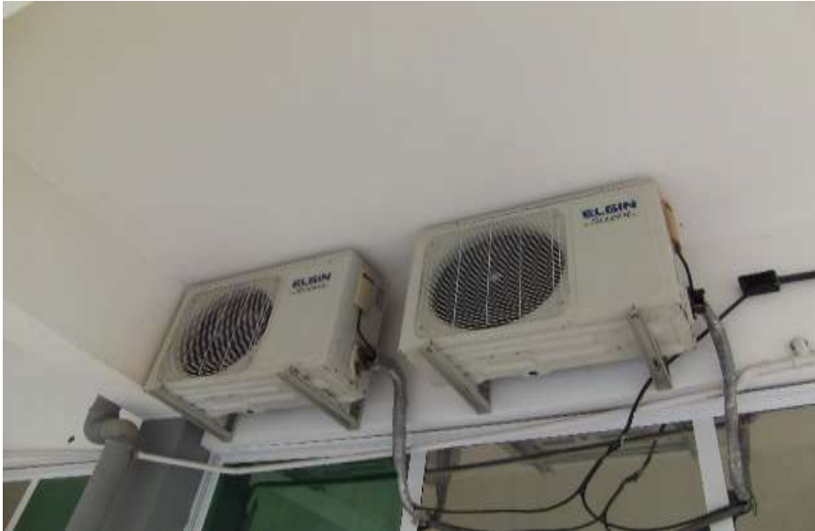
Figura 1 - Condensadora sala de Tecnologia da Informação.
