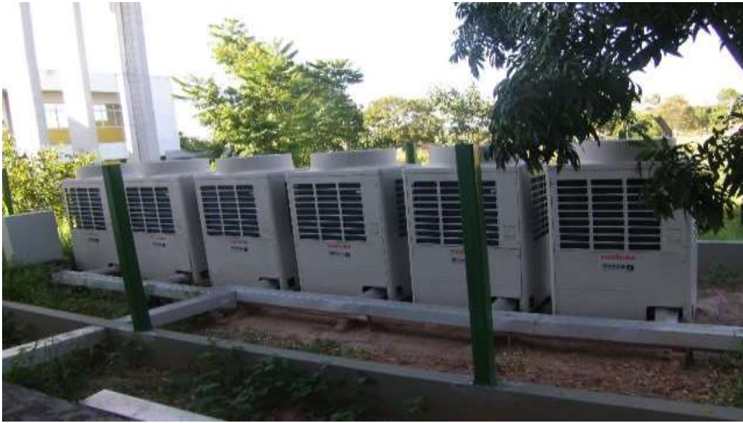
Figura 5 - Condensadoras Bloco de Laboratórios.
