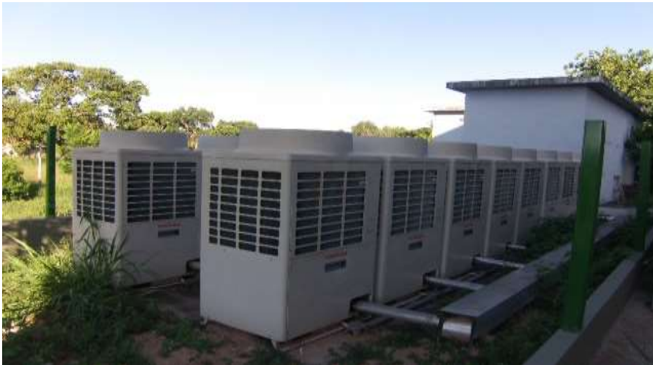
Figura 3 - Condensadoras Bloco Administrativo (vista lateral)
