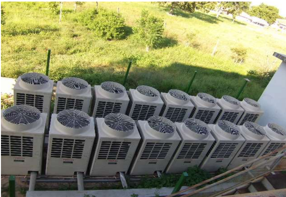
Figura 2 - Condensadoras Bloco Administrativo (vista de cima)
