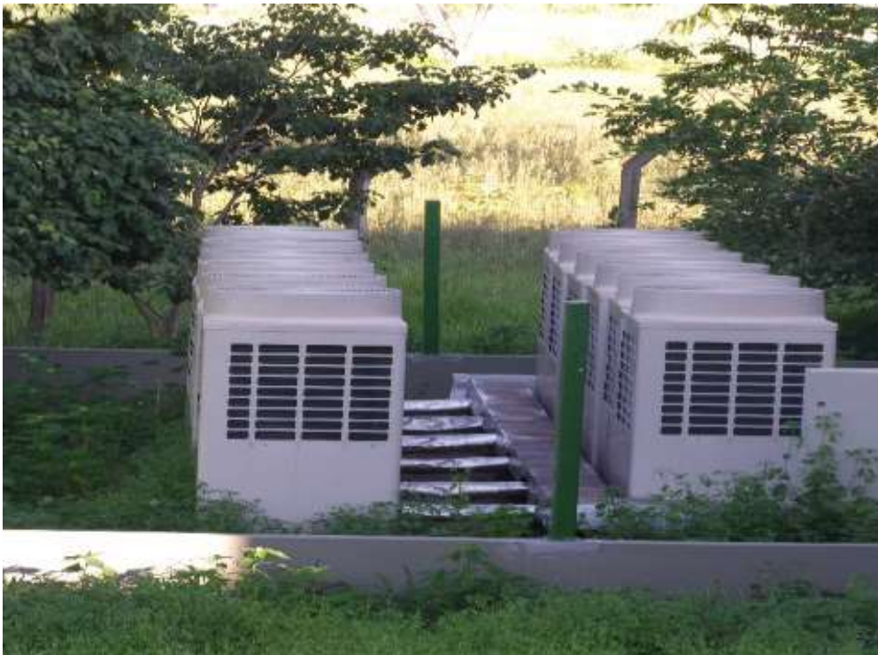
Figura 4 - Condensadoras Bloco Administrativo (vista lateral)
