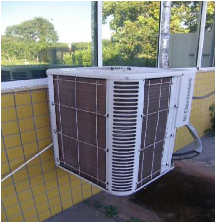
Figura 7 - Condensadoras Bloco de Laboratórios e Hotel Tecnológico
